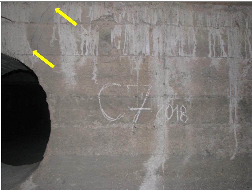
Слика 21. Прлина на попречном носачу изнад стуба С7. Конструкција К-2.
