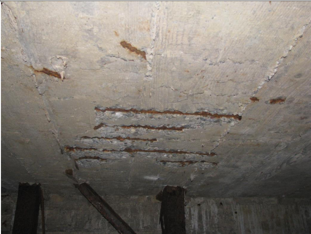
Слика 7. Видљива кородирала арматура у коловозној плочи. Поље С7-С8. Конструкција К-2
