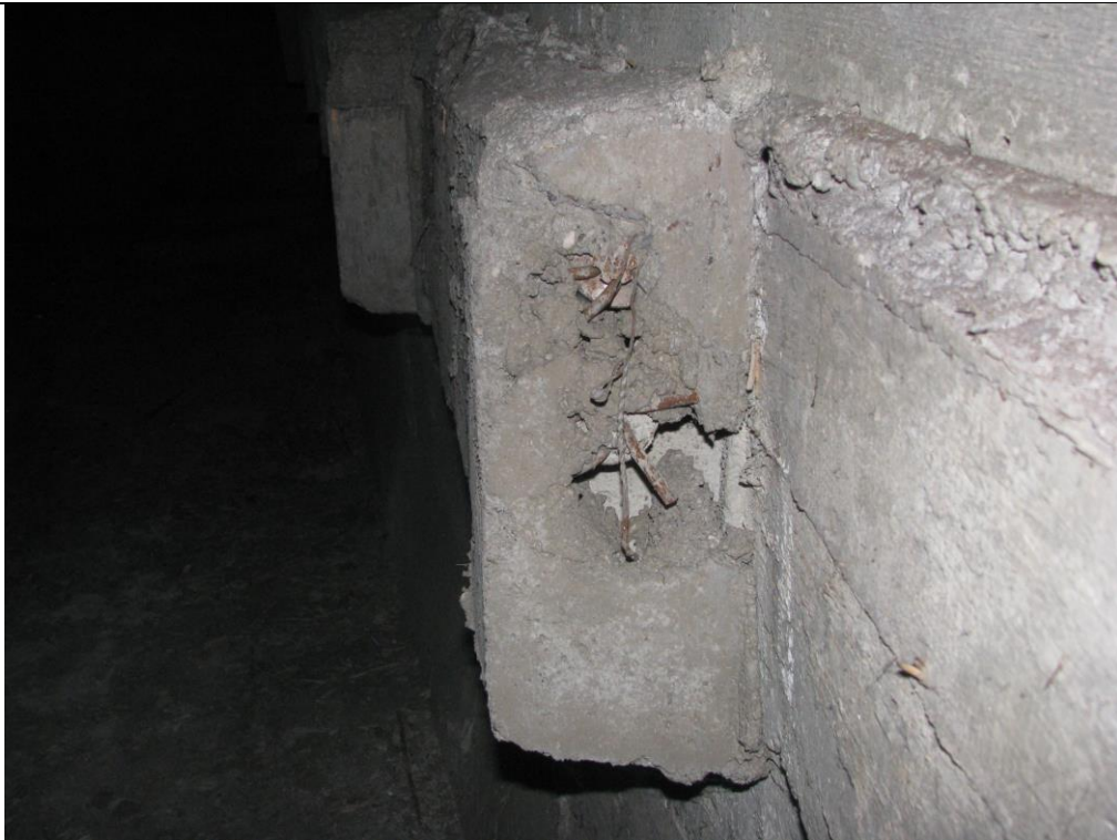
Слика 19. Чело анкер блока на ребру главног носача није адекватно обрађено. Видљива арматура и котва кабла за преднапрезање. Конструкција К-2.
