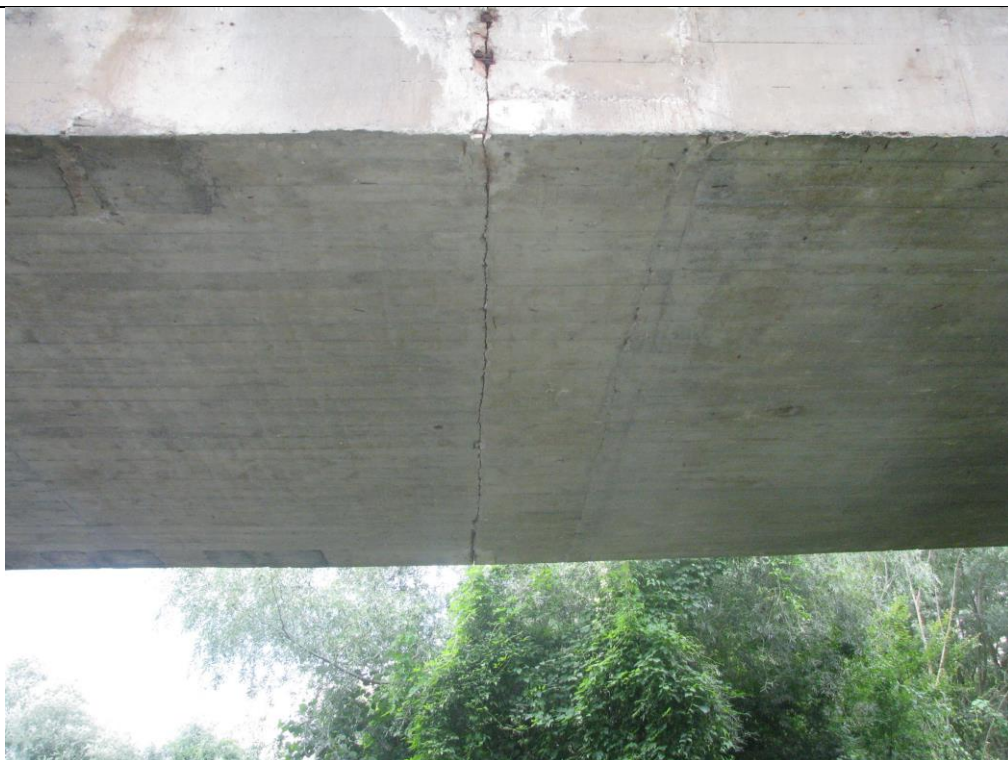
Слика 11. Пукотина у доњој плочи сандука по целој ширини и дебљини плоче. Конструкција К-1. Поље С2-С3. Споља
