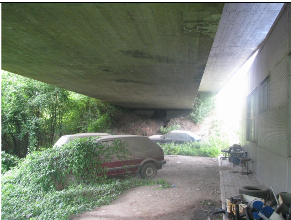
Слика 24. Поглед на обални стуб С1. Лежиште је неприступачно и затрпано. У простору испод моста је вегетација, аутомобили и отпад. Приземна грађевина је делом у габариту мостовске конструкције.
