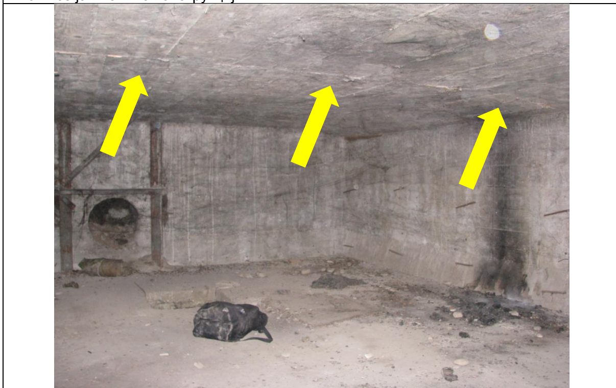
Слика 6. Прслина у коловозној плочи са појавом калцификације. Конструкција К-1. Исте прслине се јављају и на конструкцији К-2
