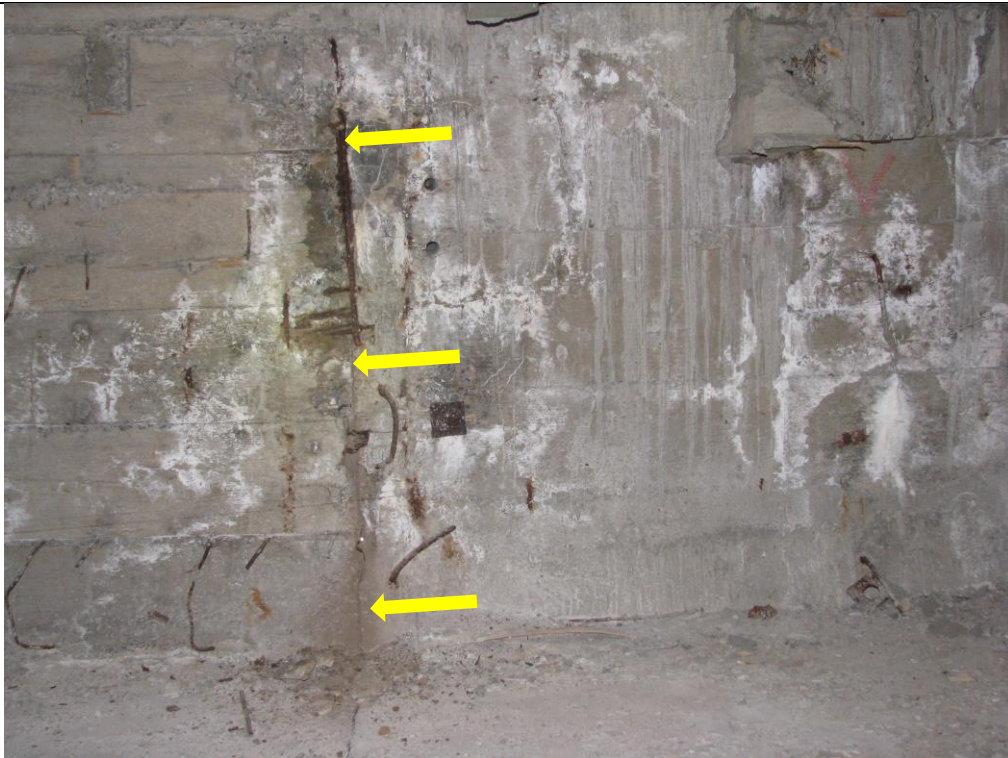
Слика 15. Пукотина у ребру сандука целом висином ребра. Поље С2-С3. Конструкција К-1.
