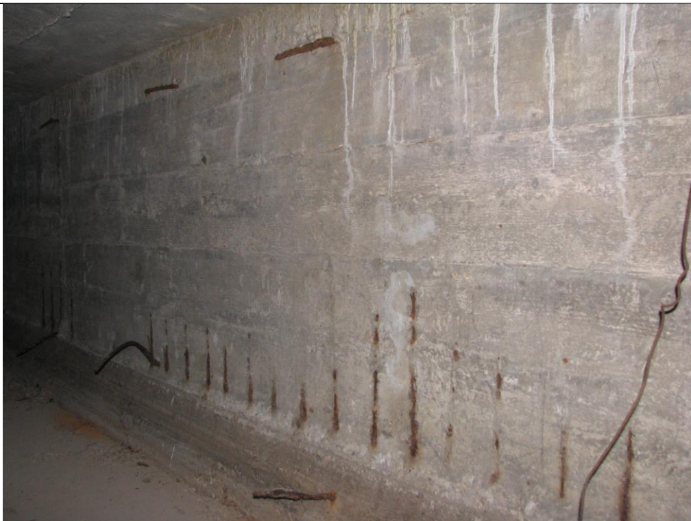
Слика 18. Мали заштитни слој и видљива арматура у ребру главног носача. Конструкција К-2.
