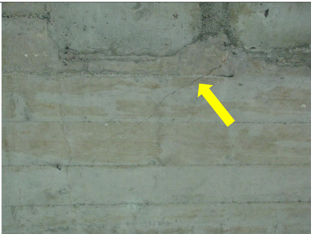
Слика 12. Пукотина у доњој плочи сандука у зони анкер блока. Конструкција К-1, поглед са спољашње стране.
