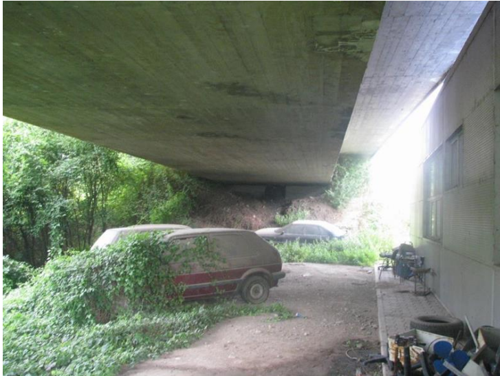
Слика 2: Објекат уз конструкцију моста и отпадни материјал
