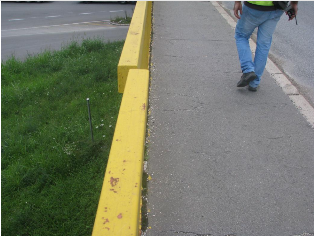
Слика 3. Низводна ограда пешачка стаза моста, са видним деформацијама-смакнућима рукохвата ограде .
