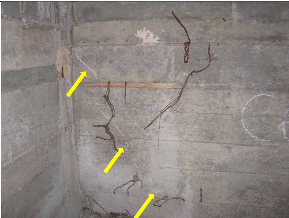
Слика 20. Прслина на попречном носачу изнад стуба С6. Конструкција К-2.
