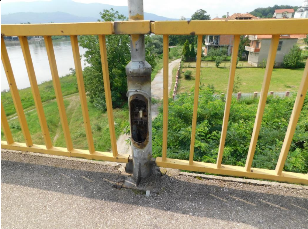
Слика 4. Карактеристично стање стубова електро расвете. Недостају заштитни поклопци. Изражена корозија на стубовима расвете.
