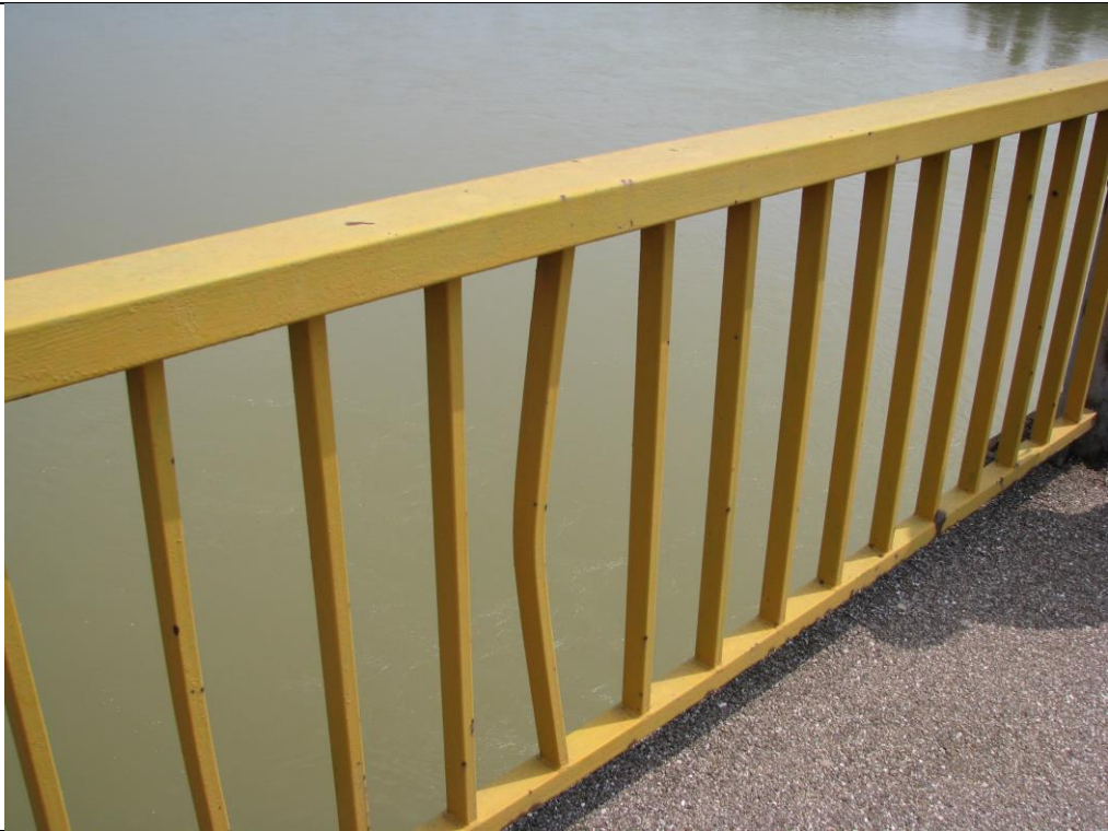
Слика 3. Низводна ограда пешачке стазе моста, са видним деформацијама вертикалне испуне ограде.
