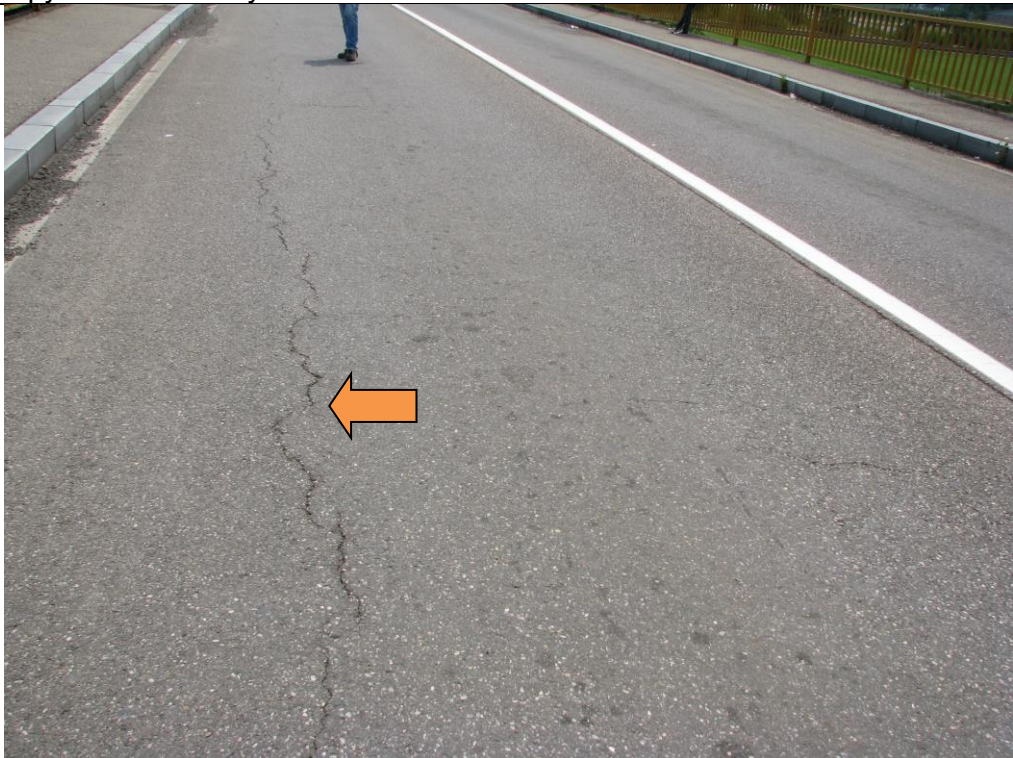
Слика 2. Подужне прслине на асфалу.
