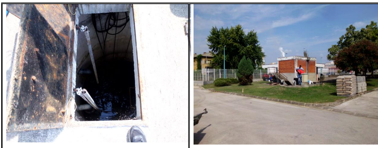
Sabirna jama pre ispuštanja u kanalizaciju
