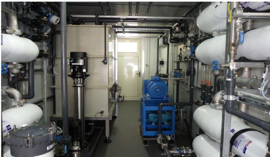
Слика 1-5 Унутрашњост контејнерског постројења за третман отпадних вода
