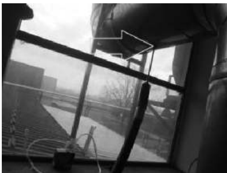
Slika 68. Merno mesto na emiteru sistema ventilacije sa miksera
