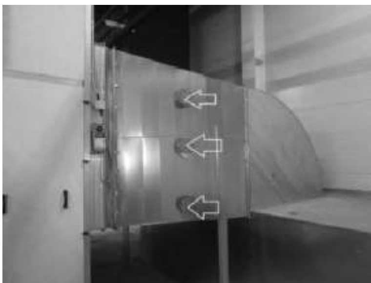
Slika 69. Merno mesto na emiteru sistema opšte i lokalne ventilacije iz pogona SVR
