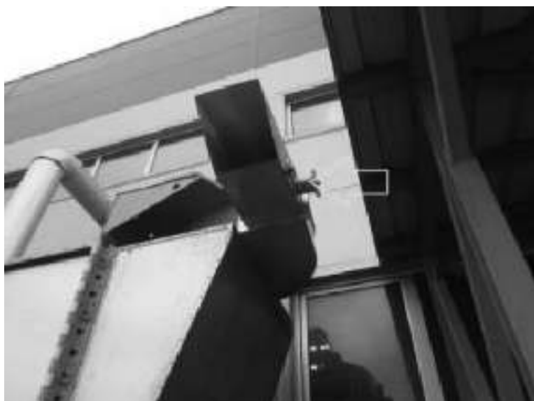
Slika 70. Merno mesto na emiteru sistema ventilacije sa miksera
