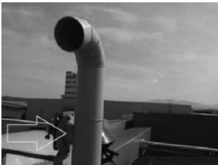
Slika 67. Merno mesto na emiteru sistema ventilacije sa rezervoara za HCl
