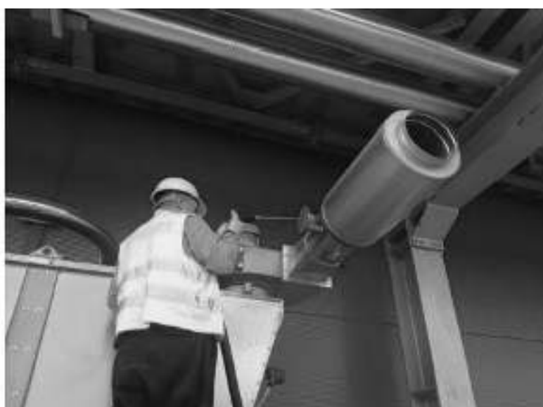
Slika 74. Merno mesto na emiteru sistema ventilacije sa dozirne stanice
