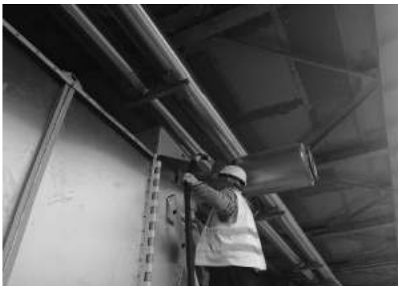
Slika 73. Merno mesto na emiteru sistema ventilacije sa miksera
