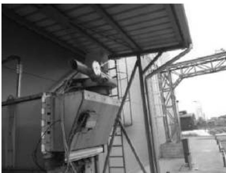
Slika 71. Merno mesto na emiteru sistema ventilacije sa dozirne stanice
