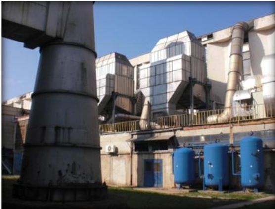
Слика бр. 58: Рекулатори топлоте на јужном зиду објекта картон машине
