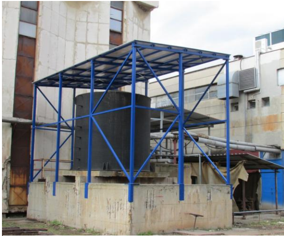
Слика бр. 29: Резервоар за складиштење хлороводоничне киселине (HCl)
