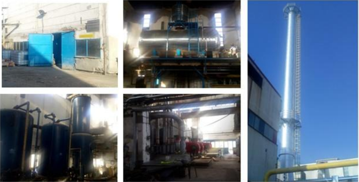
Слика бр. 41: Котларница (парни котлови и димњак)
