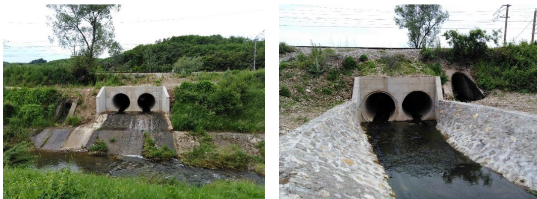
Слика 3. Пропуст кроз тело насипа железничке пруге Београд -Бар на месту улива потока Сикијевац у Топчидерску реку
