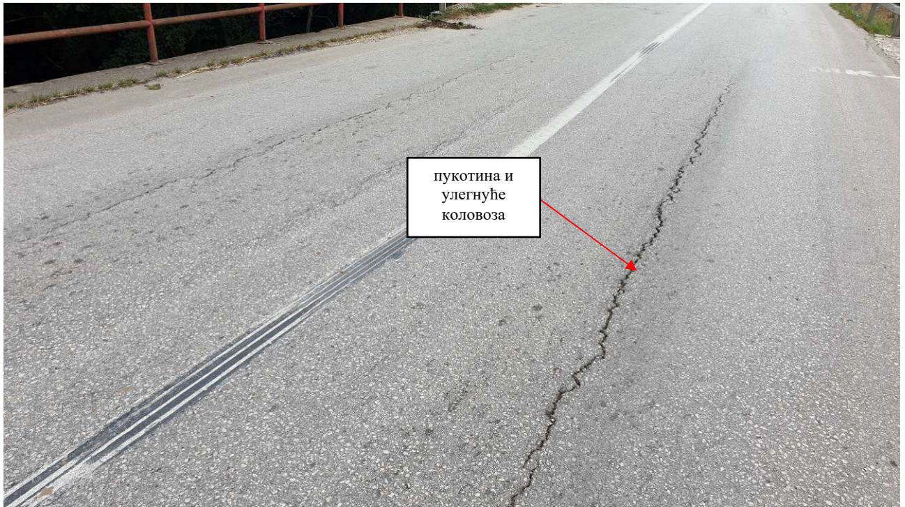
Оштећења на коловозу
