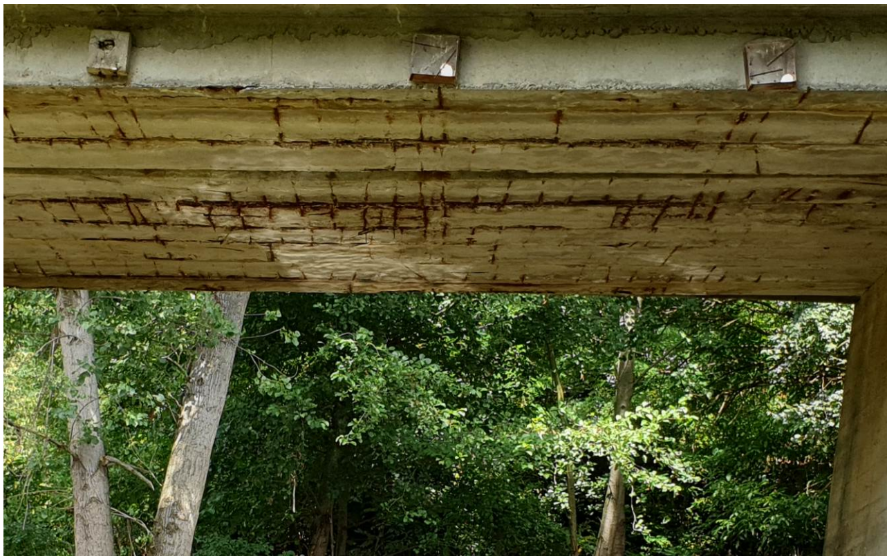
Пропали средњи носачи, оштећен заштитни слој и корозија арматуре
