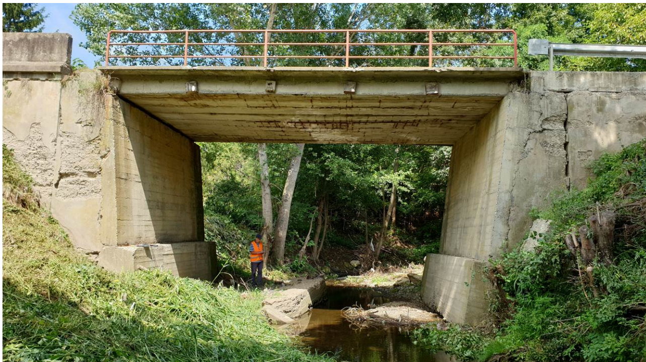
Оштећен бетон стубова и крилних зидова - узводна страна
