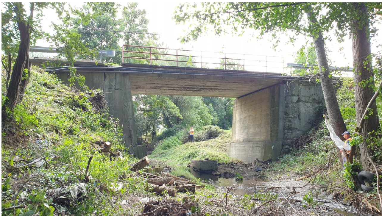
Оштећен бетон стубова и крилних зидова - низводна страна
