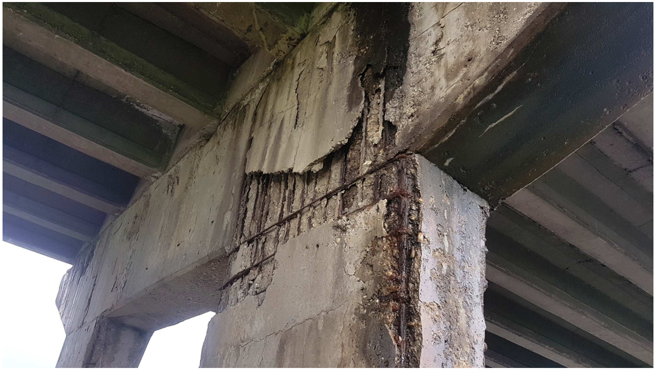
Фотографија 9 – Оштећења на лежишној греди и стубу С3 у разделном појасу: трагови процуривања воде, прслине, отпао заштитни слој, корозија арматуре
