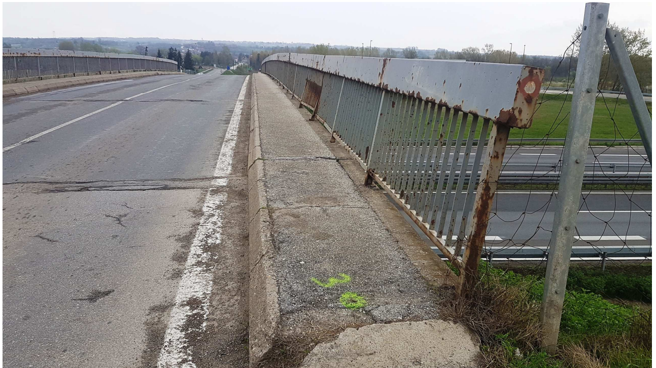
Фотографија 5 – Оштећења на асфалтној дилатацији изнад стуба С1, пешачкој стази и корозија ограде (поглед ка Коларима)
