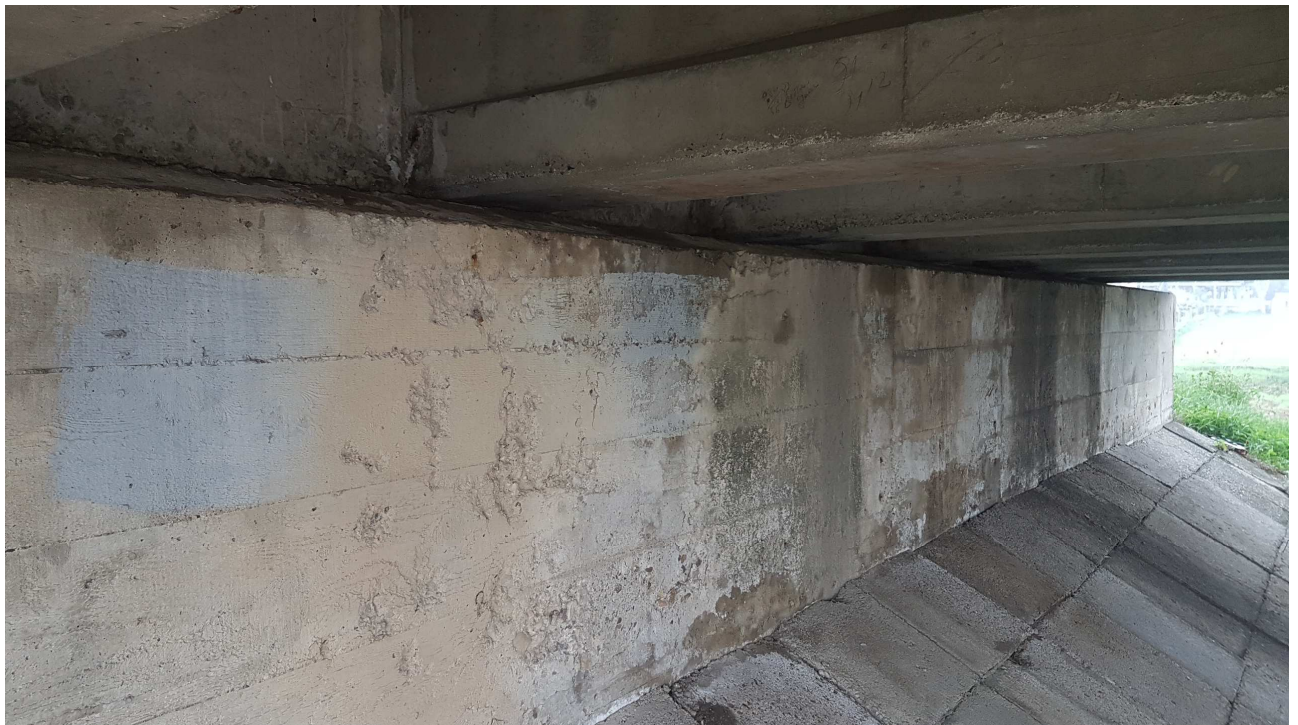
Фотографија 15 – Трагови проциривања воде на крајњем стубу С5
