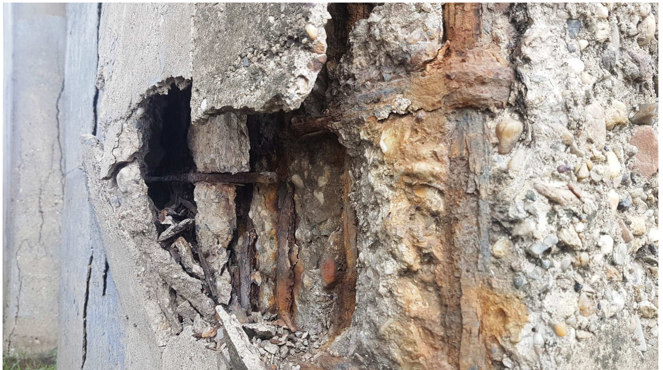
Фотографија 10 – Оштећења на стубу С3 у разделном појасу: отпао заштитни слој, корозија и потпуни прекид арматуре
