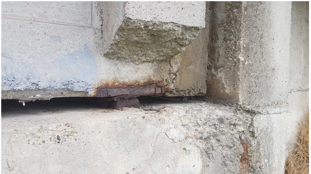
Фотографија 6 – Корозија покретног лежишта на крајњем стубу С1 и оштећење маске анкерног блока попречног носача
