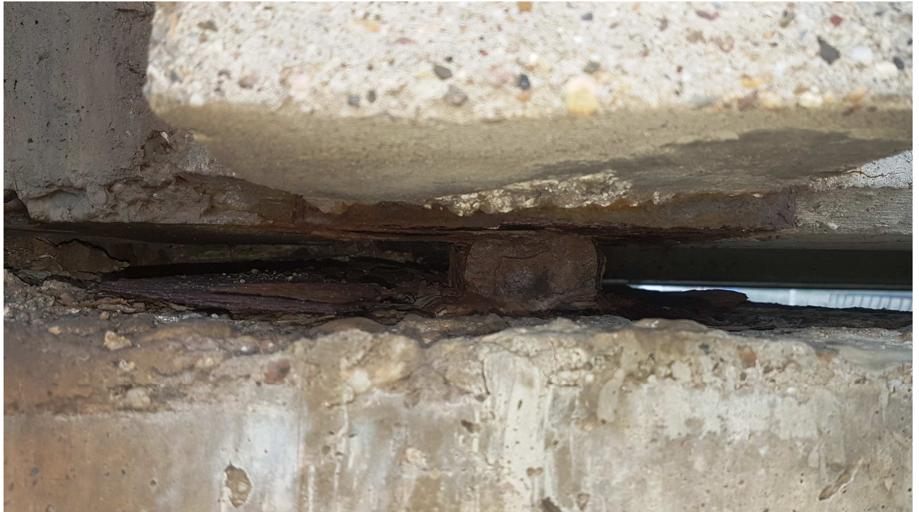
Фотографија 14 – Покретно лежиште на стубу С5: корозија шине и лежишне плоче
