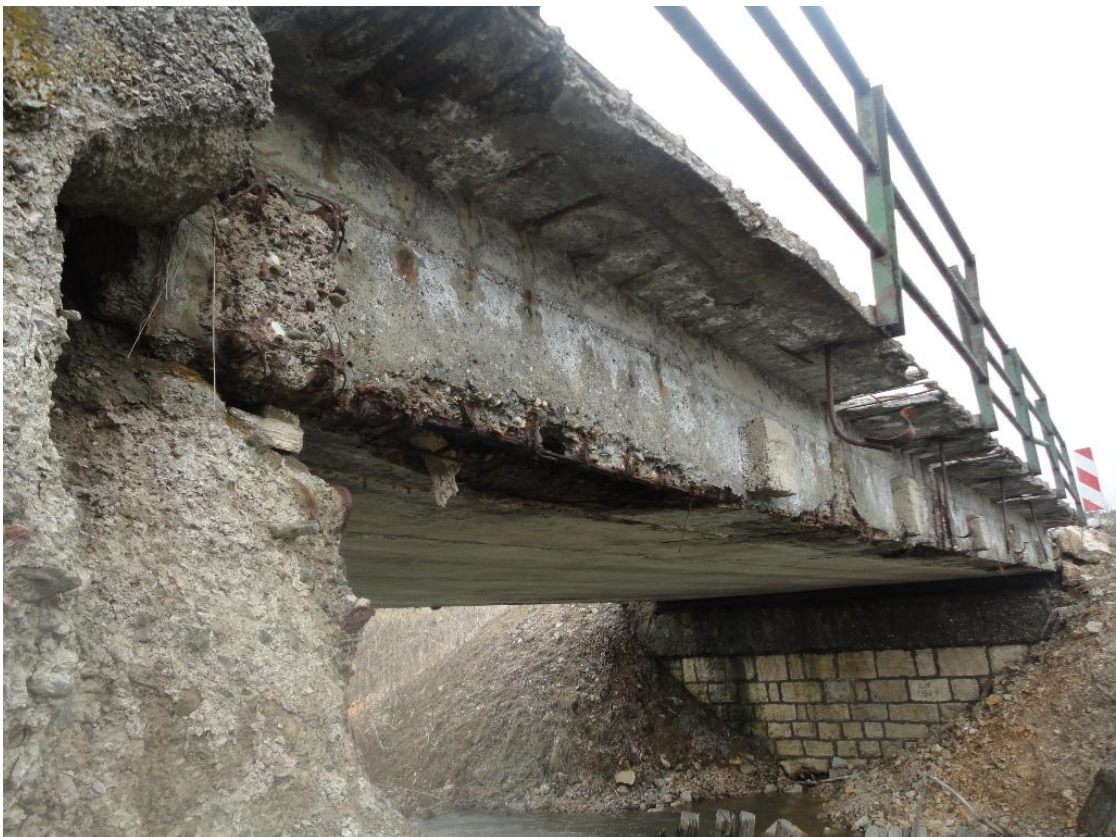
Оштећења ивичног носача са пробојем доње бетонске плоче
