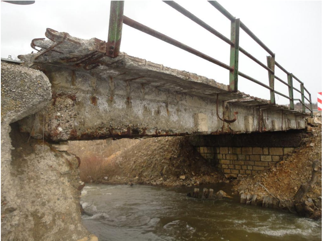
Оштећења на конзоли пешачке стазе и небезбедна зона ослањања носача
