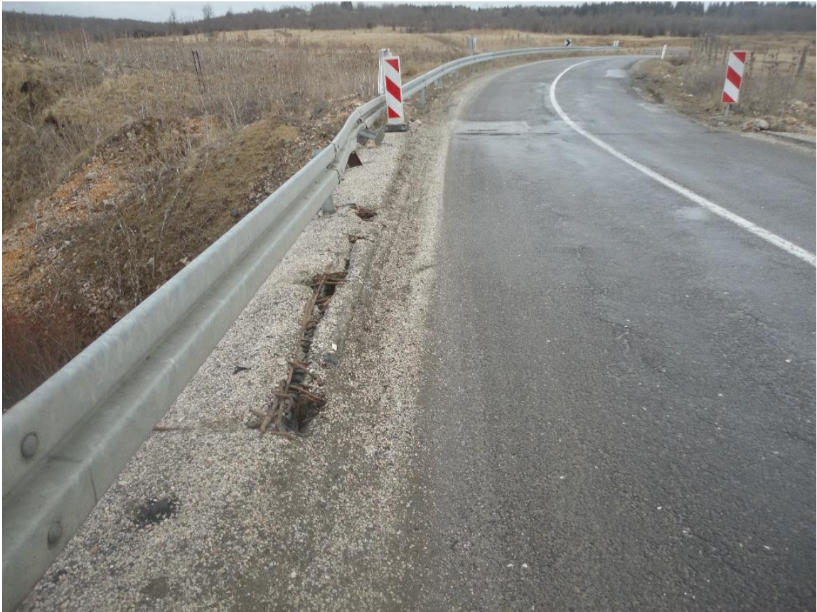
Оштећени бетон и арматура на пешачкој стази
