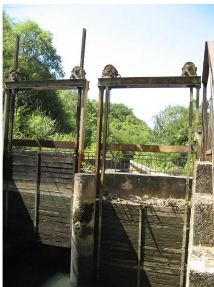
Slika 21.c Dva tablasta zatvarača na ulazu u derivacioni kanal.
