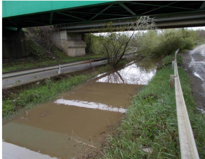
Слика 7.1.1-1 Сужење испод моста у близини споја ободног канала са старим коритом реке Кладнице
