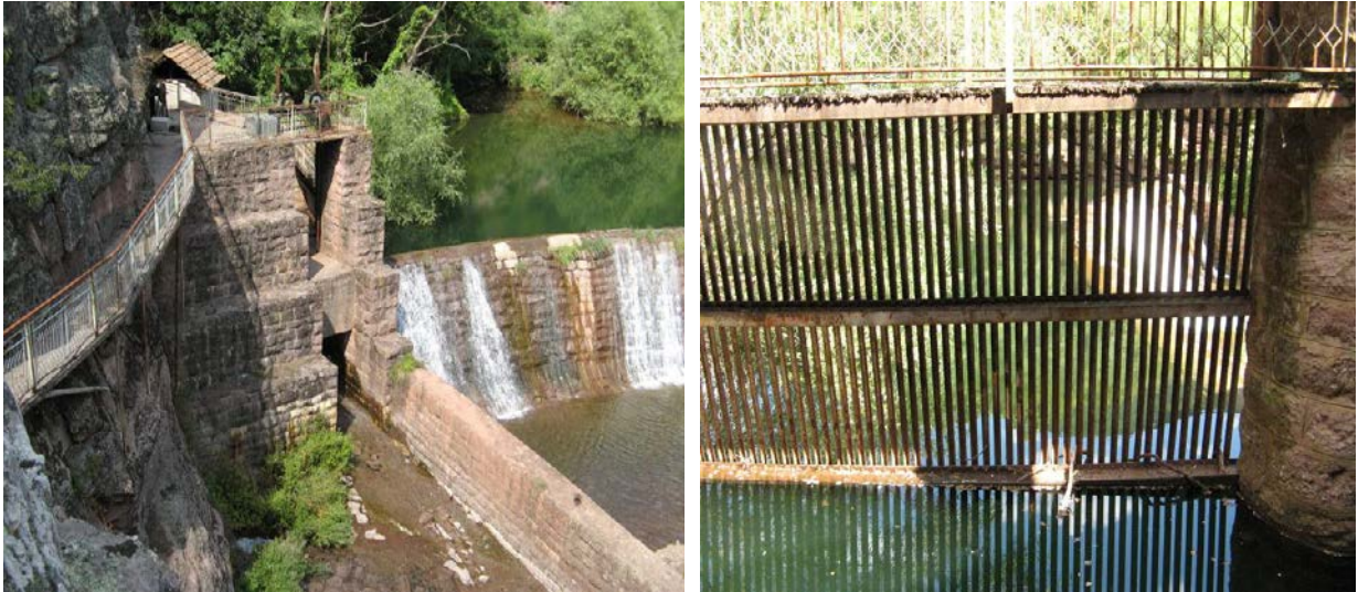
Slika 3.8 Vodozahvat sa grubom rešetkom
