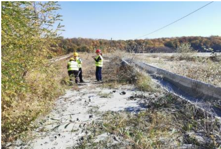
Слика 3.5. Бетонски канал за гравитацијски транспорт јаловине од ПС2 до ПС Калуђерица
