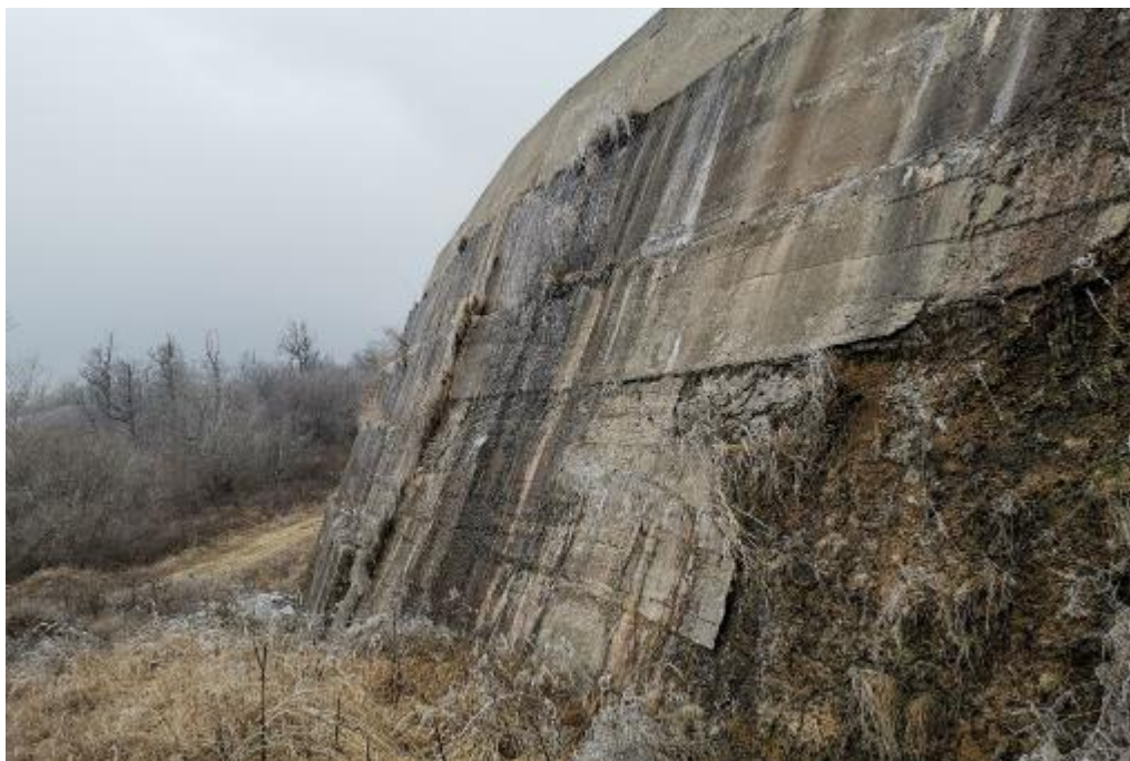
Слика 3.19. Оштећења на спољашњој косини бетонске бране, јануар 2020. године
