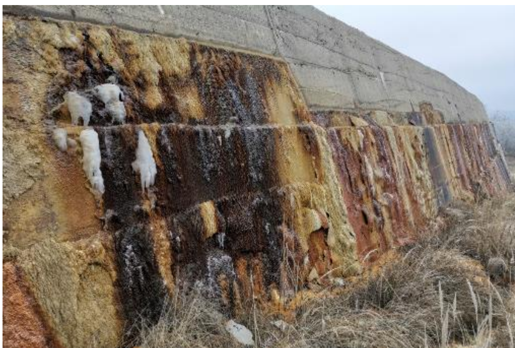
Слика 3.18. Спољашња косина бетонске бране, јужни део, 2020. године
