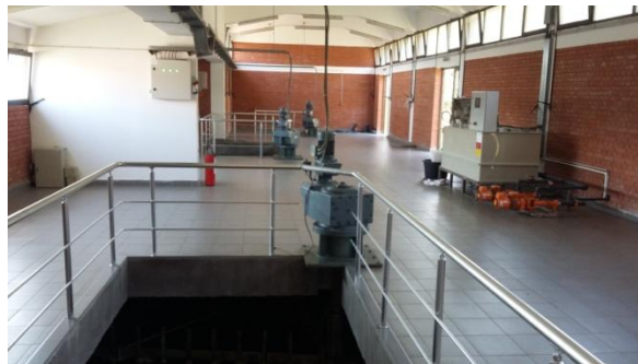
Слика бр. 24: Унутрашњост објекта за коагулацију и флокулацију
