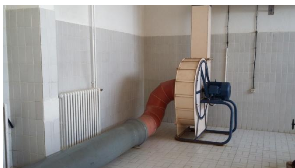
Слика бр. 41: Вентилатор за систем неутрализације хлора
