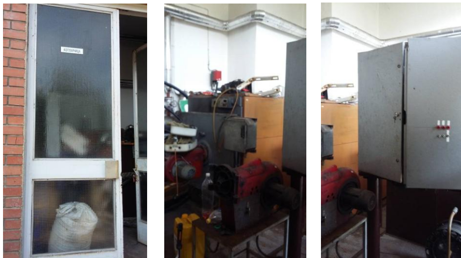
Слика бр. 34: Котларница
