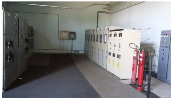
Слика бр. 38: Унутрашњост електроблока
