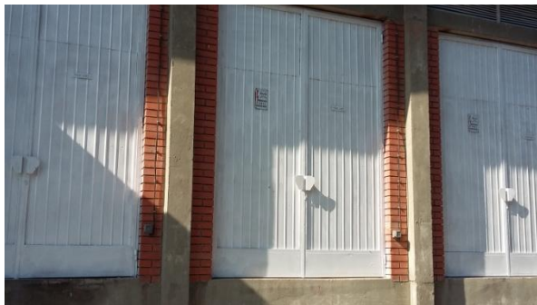
Слика бр. 37: Трансформаторска станица
