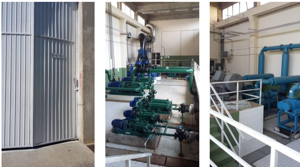
Слика бр. 35: Компресорско - пумпна станица
