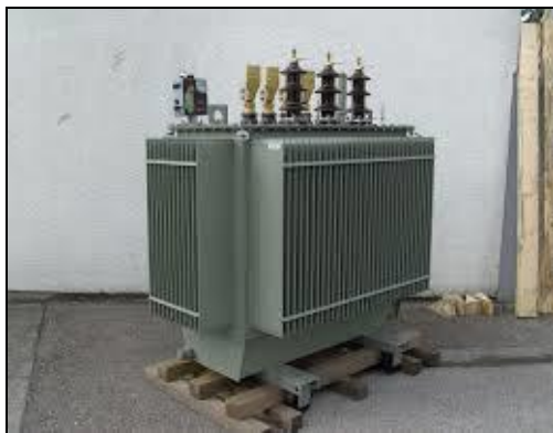
Слика 30. – Изглед трансформатора
